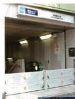
上の写真は駅入り口の止水板、下は地下鉄トンネル内の防水ゲートです。
