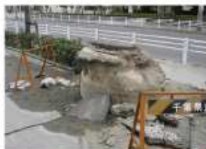
地震による地盤の液状化で、マンホールがうき出ってしまった状態。
